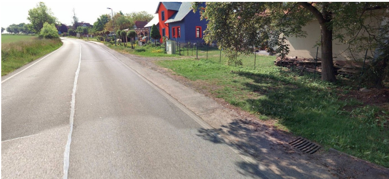
Foto 2 – pohled úsek chodníku před KÚ dle dokumentace – patrné zapuštění AB krytu chodníku pod asfaltobetonové vrstvy komunikace (s úsekovým překrytím oddělení), na foto stávající uliční vpust' zajišťující odtok dešťových vod z plochy chodníku i části komunikace
